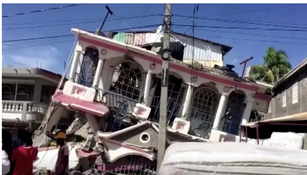
Vivienda gravemente dañada tras el terremoto.
