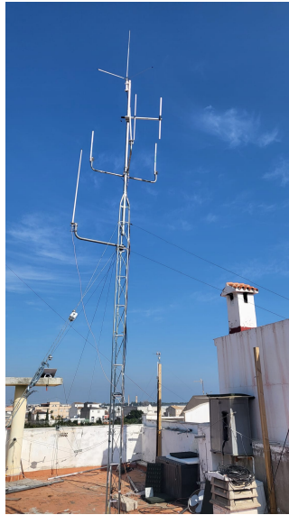
Instalación exterior de antenas: el salto desde la pequeña estación inicial.
