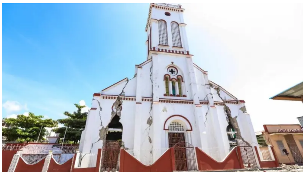
Daños visibles en un edificio religioso, reflejo de la extensión de la destrucción.
